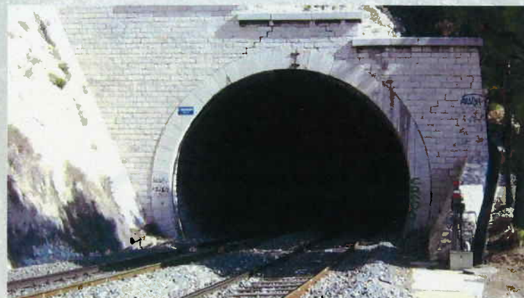
Tunnel de l'Engrenier (13) : 8 fissuromètres
